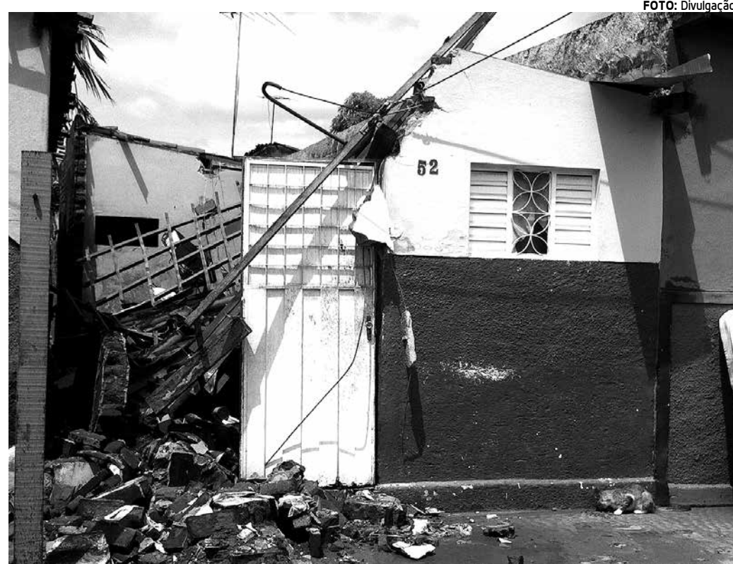
Casa na comunidade do Frango não resistiu ao temporal da última terça-feira e desabou
